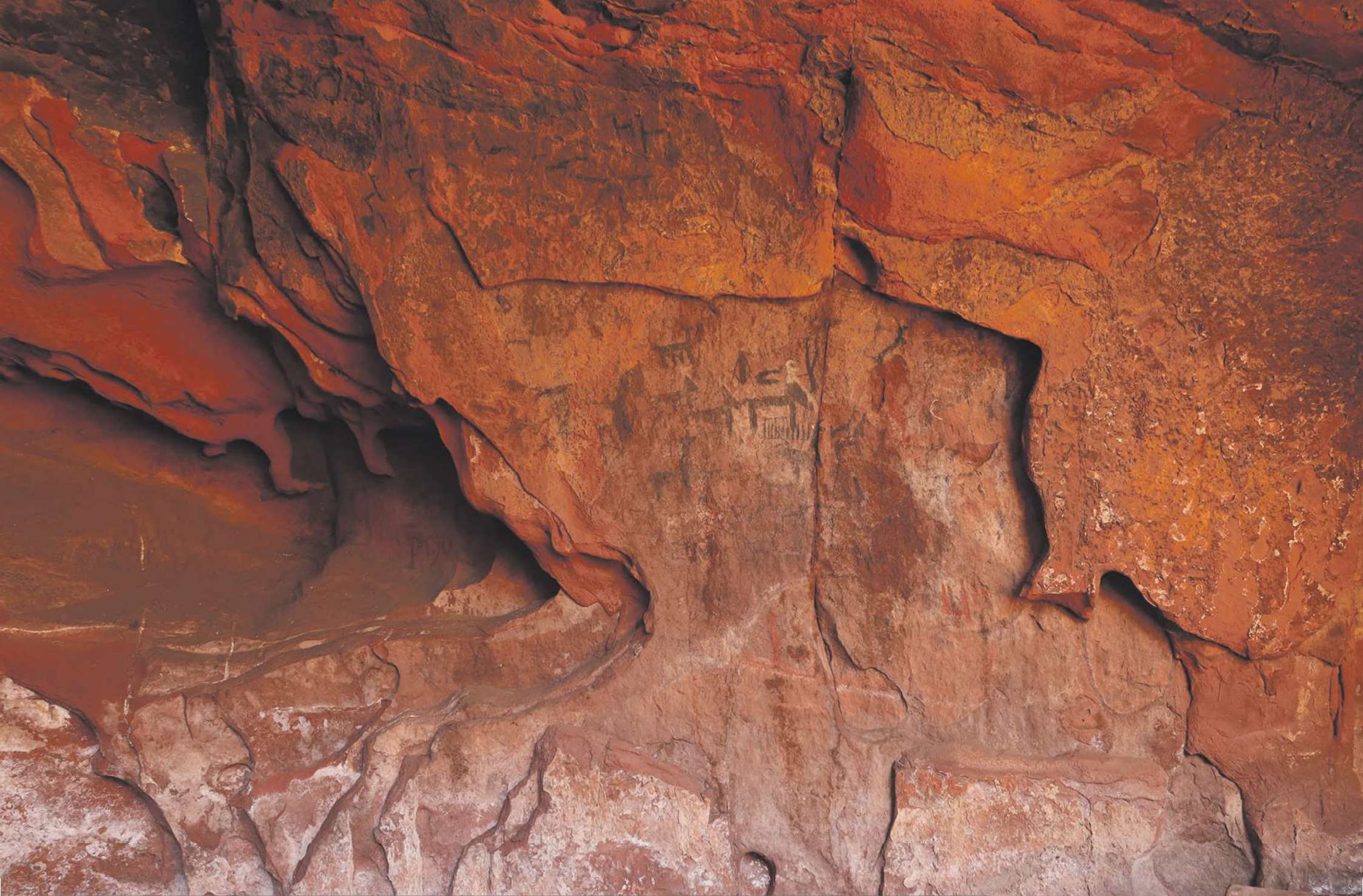
Exfoliación de la roca soporte, eflorescencia de sales solubles y presencia de biodeterioro en Inca Cueva 1
