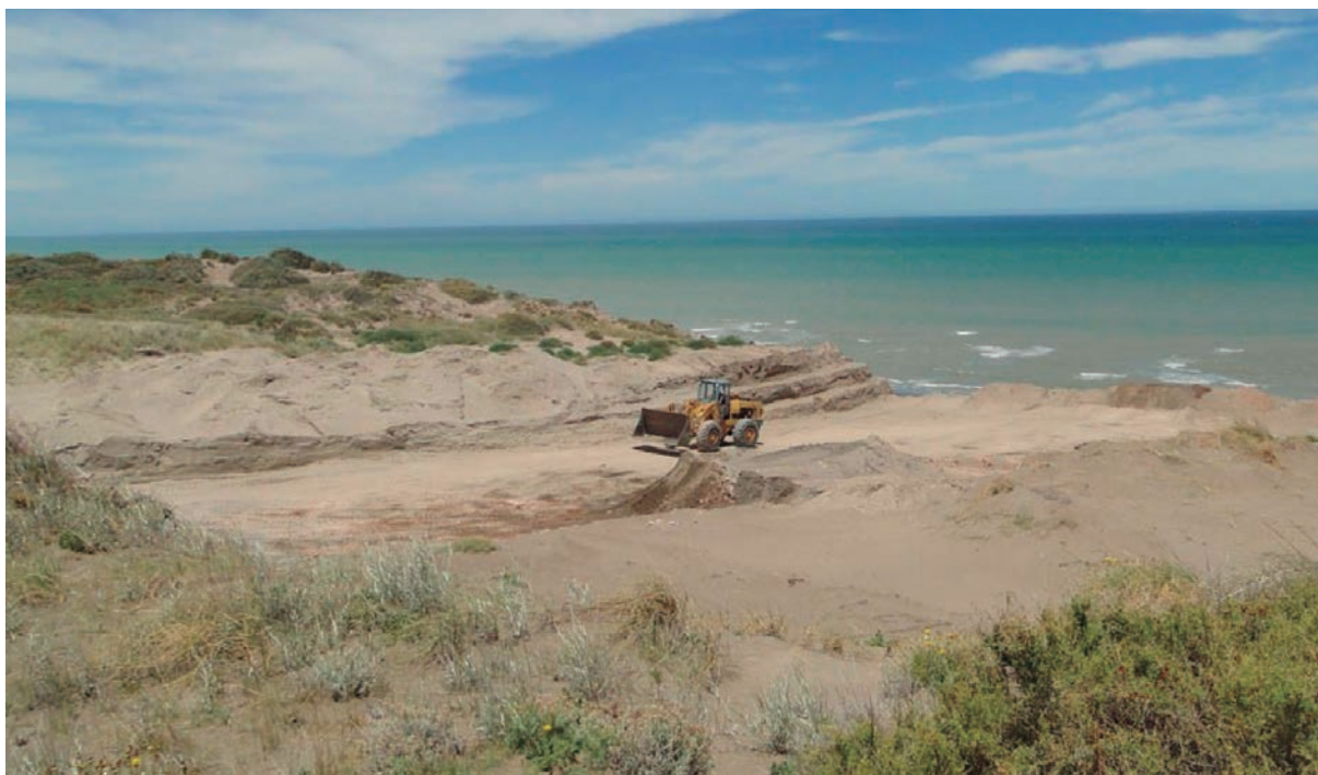
Foto 5. Territorio de nidificación de Falco peregrinus en 2014. Estas obras clandestinas, que se iniciaron en 2015, pretendían un acceso a la playa destruyendo el acantilado. Se presume que la pareja abandonó el área e intentó reproducirse, finalmente sin éxito, en cercanía a otras dos parejas del núcleo del ANP Punta Bermeja. Foto obtenida del portal del gobierno de la provincia de Río Negro. http://www.rionegro.gov.ar/index.php?contID=26930
